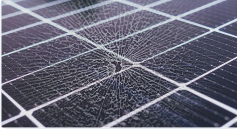
Fotoğraf 7.1 — Cam kırığı / çatlak modül kontrolü PB-01 Panel 4: Temmuz'da değiştirilen modülde yeniden cam kırığı.
